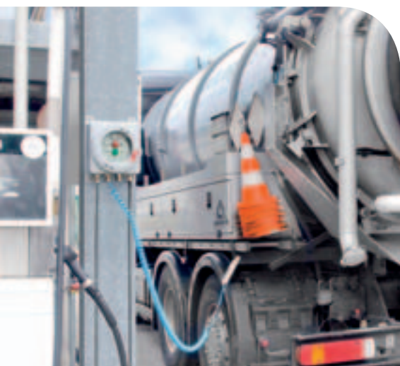
Messa a terra attiva su autocisterne
