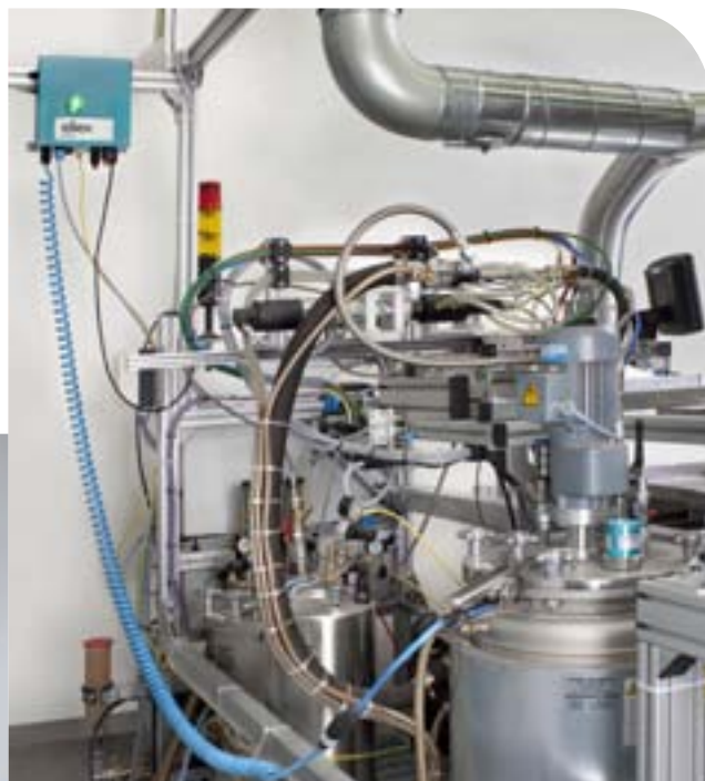
Messa a terra attiva su container e botti
